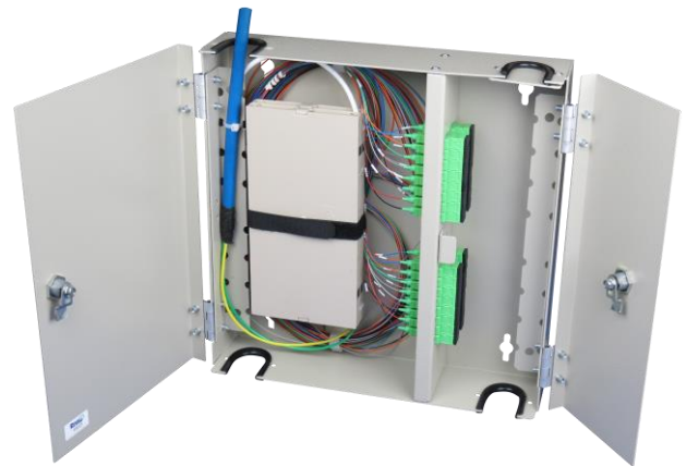
Simulação da montagem com entrada através de cabo interno, pigtails com reserva técnica e adaptadores
