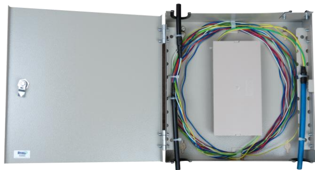
Simulação da acomodação interna das emendas com sangria do cabo de entrada
